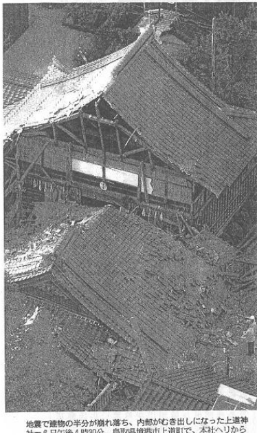
地震で建物の半分が崩れ落ち、内部がむき出しになった上道神 44-2 0104 040001 鳥取県鳥取市上道神にて、本社へりから
