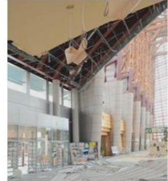
▲9月に第3回手話パフォーマンス 甲子園が行われた鳥取県立倉吉未来中心。 天井が割れ落ちました。
